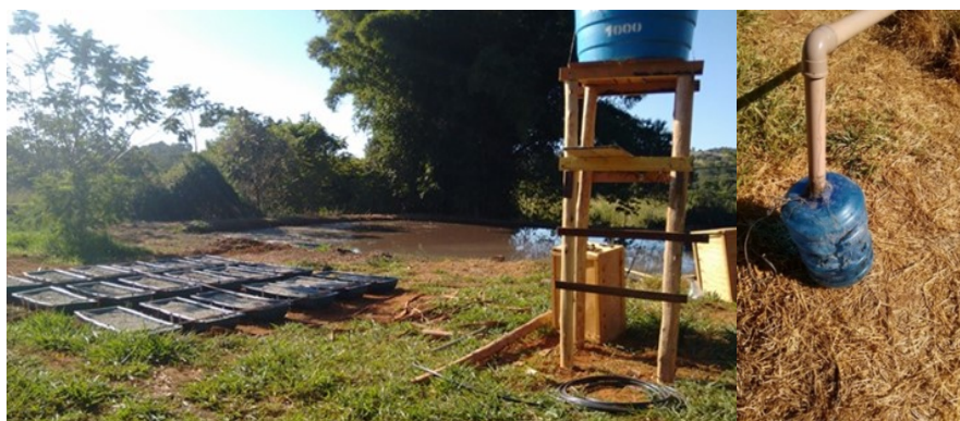
Figura 2 - Sistema de captação de esgoto doméstico mostrando o reservatório, os sistemas alagados construídos e a proteção da válvula de pé com crivo.
