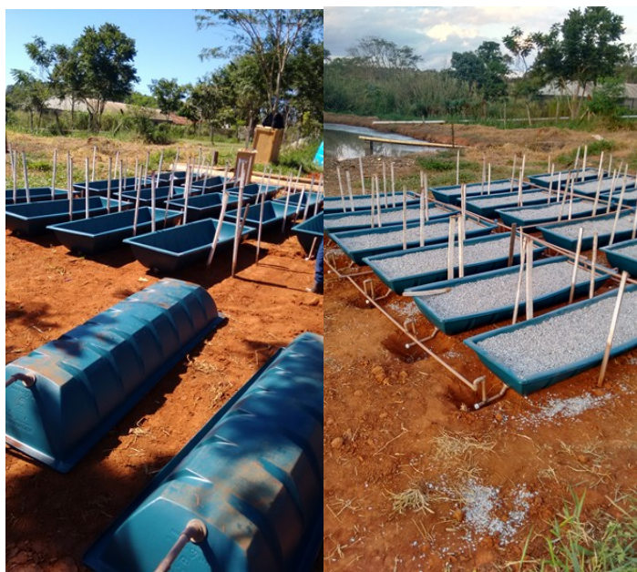
Figura 3 – Sistemas alagados construídos, em escala piloto, constituídos por cochos em pvc de fundo plano, em terreno sistematizado, preenchido meio suporte (brita #1) e tubulação reguladora de nível.
